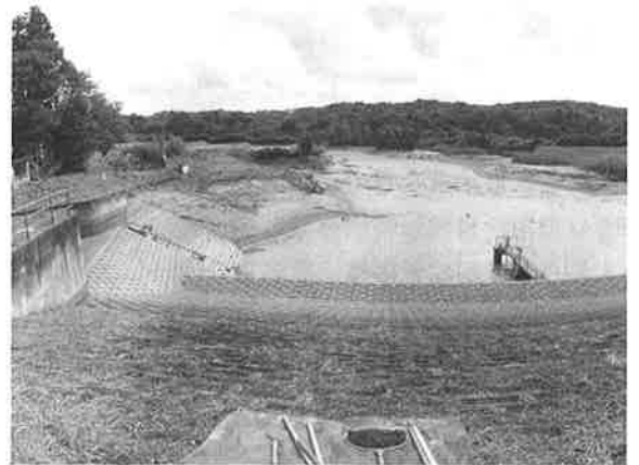
写真3 水抜きが進み、底が干上がってきたため池。堤体のほぼ中央(写真右手)に底樋、コンクリート護岸が延長された斜面(写真左手)に斜樋、その手前には余水吐が見える。なお、斜樋がある池では、斜樋の一番下が底樋になっていることが多いが、写真のように両者が離れている池もある。
